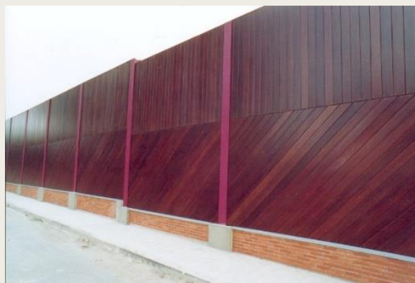
Photo: Ecrans acoustiques réfléchissants sur voie routière © M. Vernay
